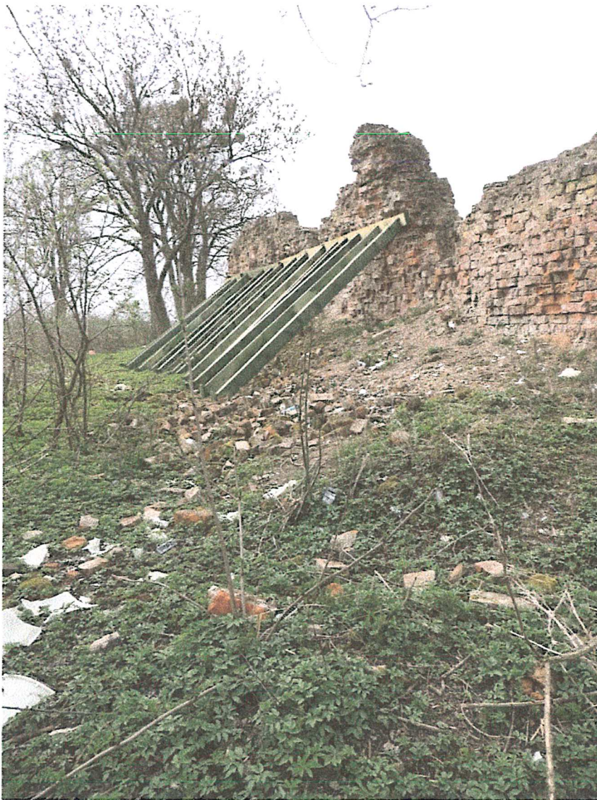
7. Widoczne zaśmiecenie terenu przy murze.
