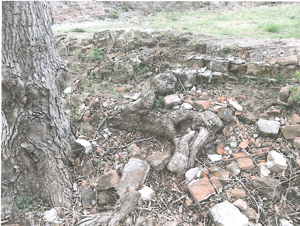
6. Mur zniszczony korzeniami drzewa.
