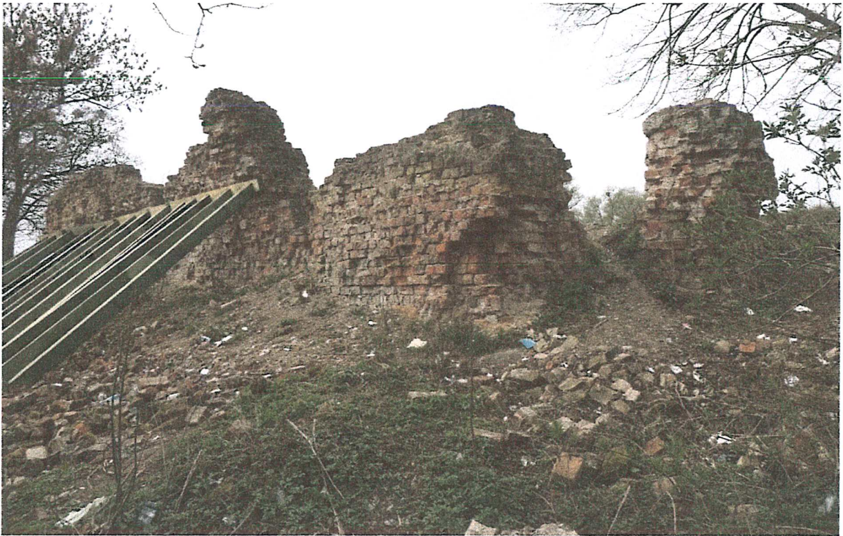
1. Mur wschodni wieży mieszkalnej. Widoczne wysypisko śmieci pod murem.
