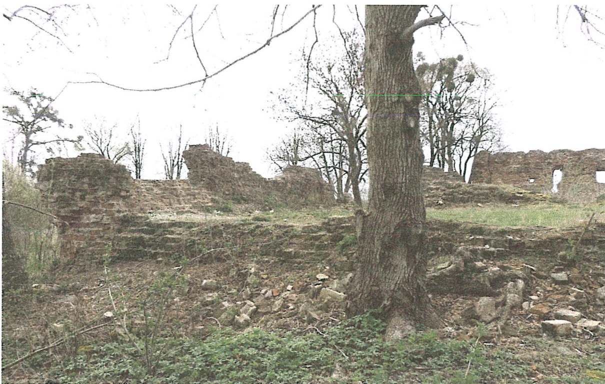
5. Niskie części muru północnego niszczone korzeniami drzewa.
