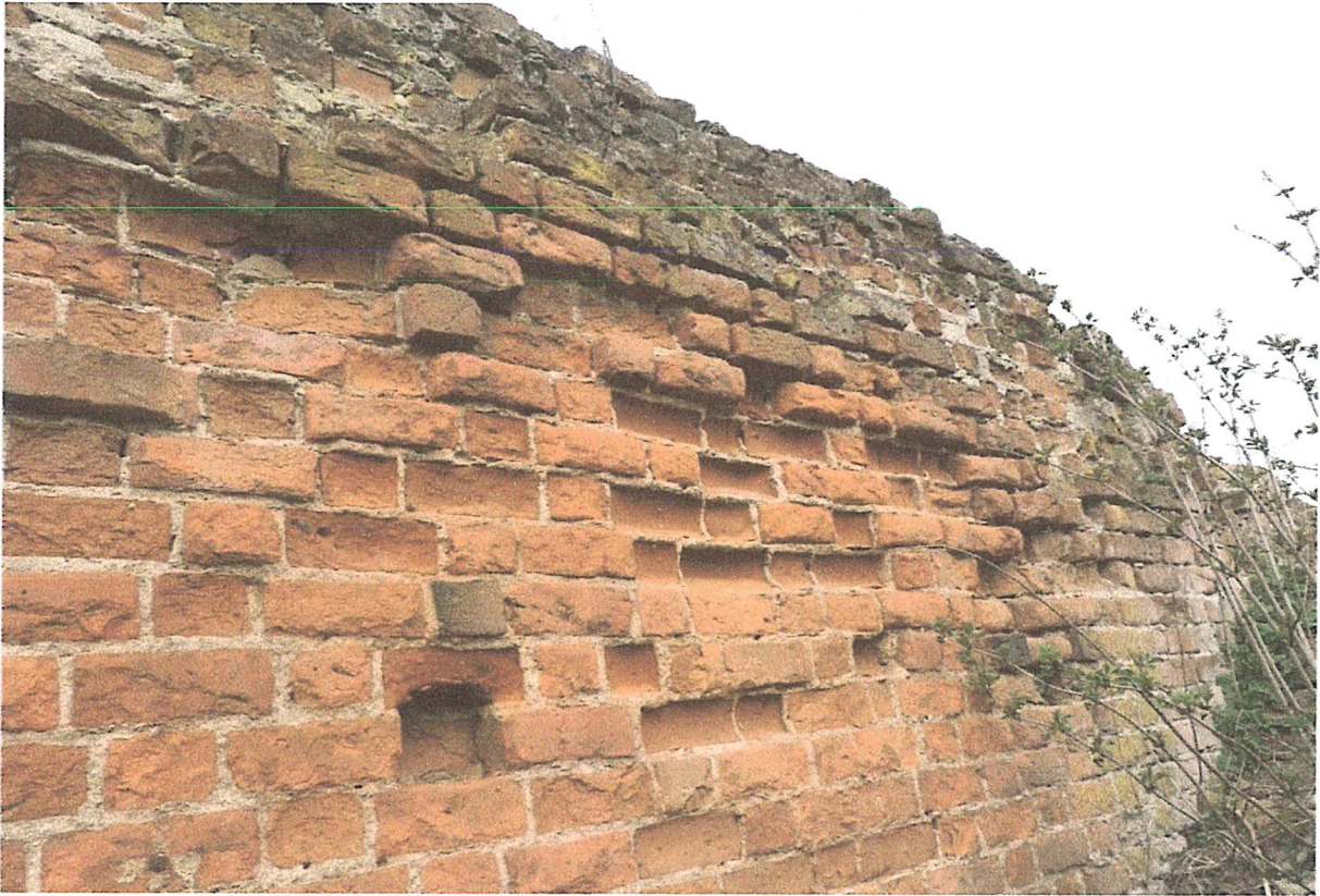
10. Zniszczone i osłabione cegły licowe ściany zachodniej, strona wewnętrzna muru.
