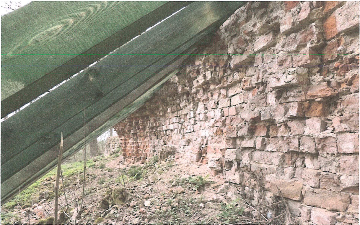
5. Zniszczony mur pod podparciem.
