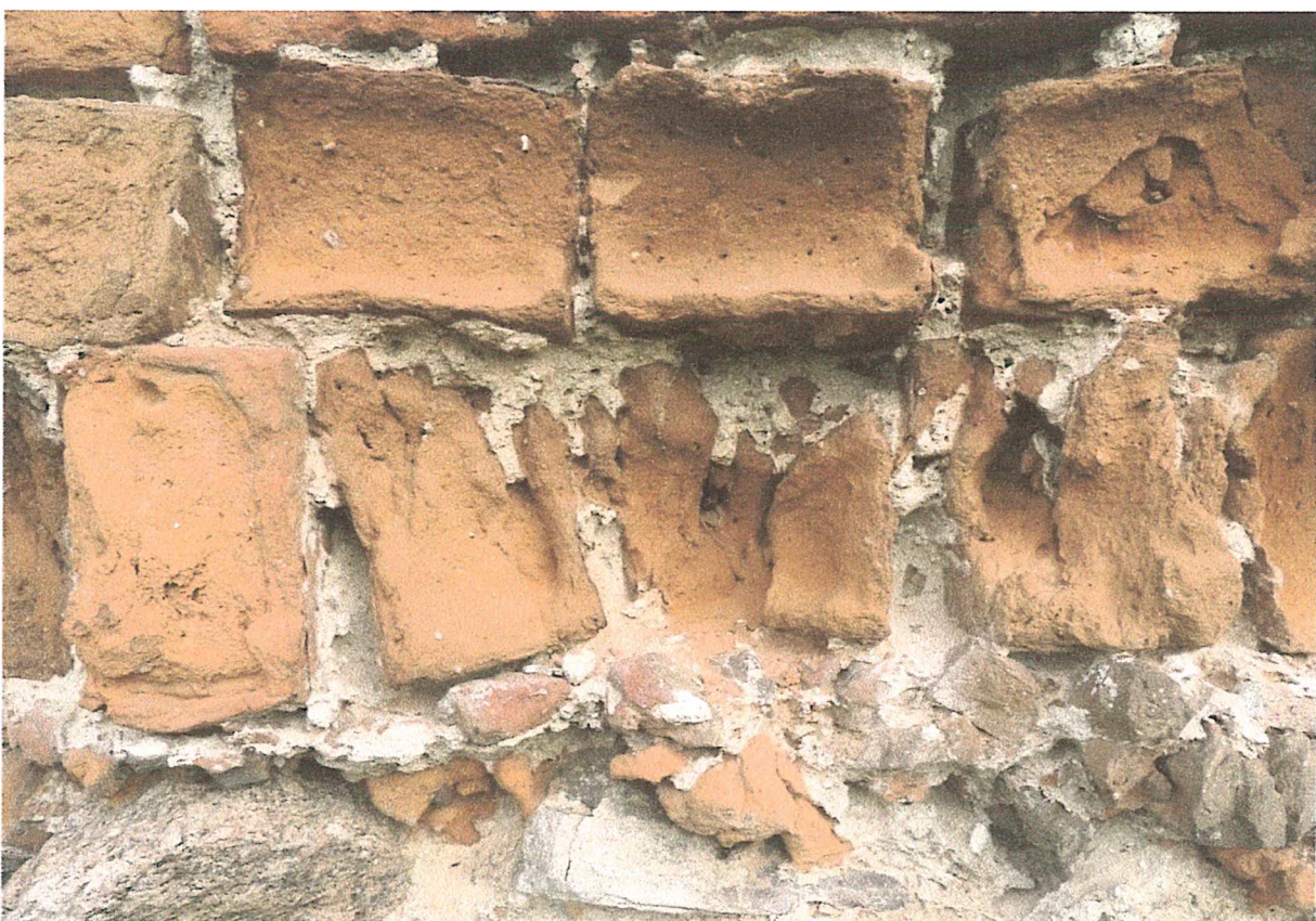
9. Proszkujące się cegły wymagające wzmocnienia.
