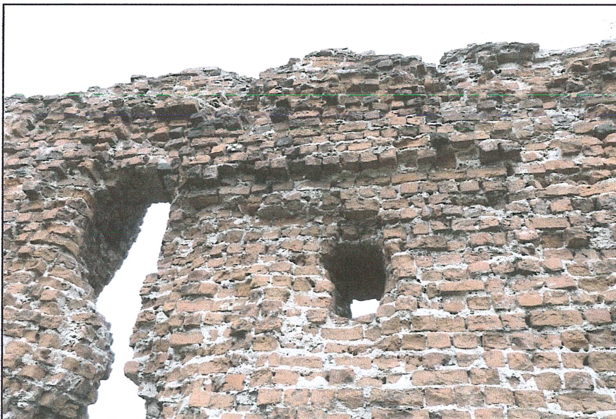
8. Zniszczenia lica muru południowego.
