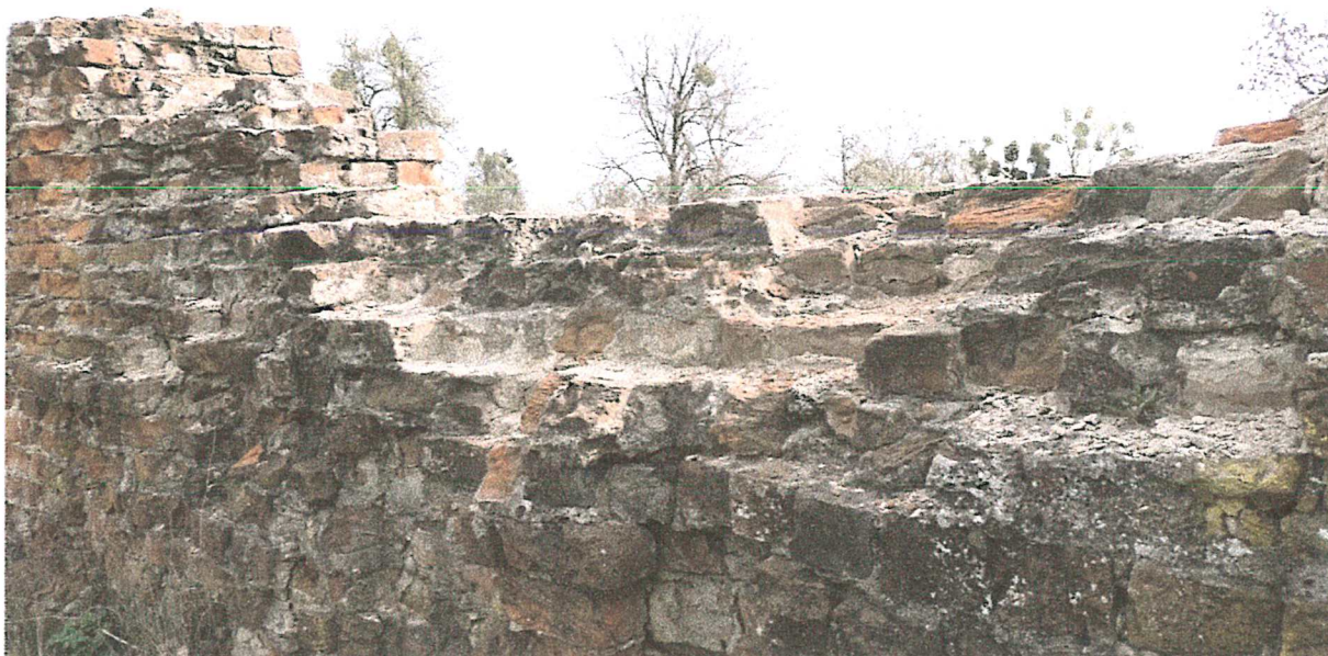
6. Niedawne zniszczenia korony muru widoczne jako miejsca o żywych i czystych barwach.
