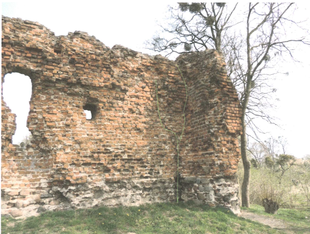
4. Szkarpa południowo wschodnia. Zieloną linią oznaczono pęknięcie w murze.
