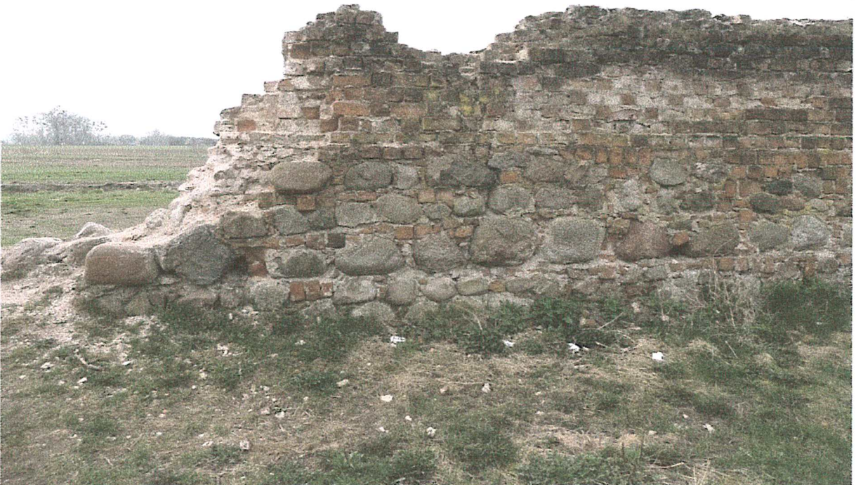
17. Strona wewnętrzna muru południowego kąca zachodniego. W górnym pasie widoczne wysolenia.
