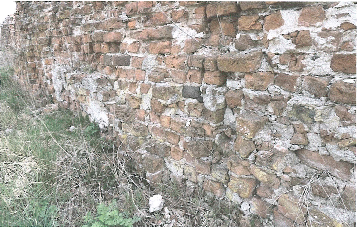
5. Zniszczenia muru, widoczny zupełny brak lica ceglanego.
