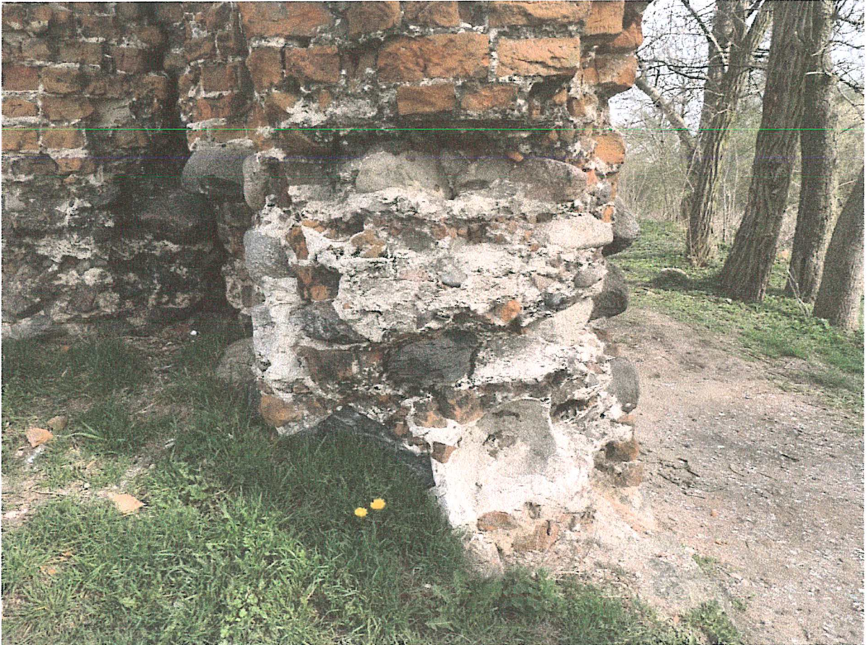
6. Zniszczenie części przyziemnej szkarpy południowo wschodniej.
