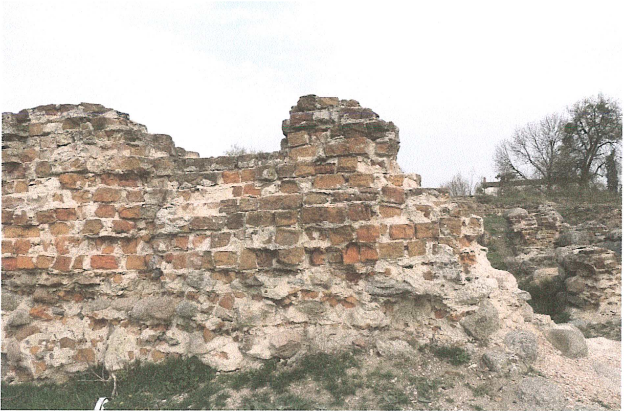
10. Zniszczenia muru przy środkowej wyrwie.
